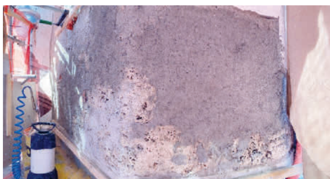
Wasserschaden am Stadtturm Baden
