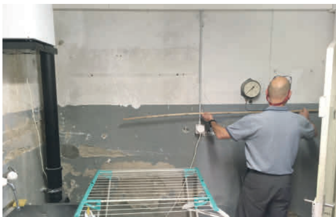
Keller mit Feuchtigkeitsschaden vor der Sanierung
