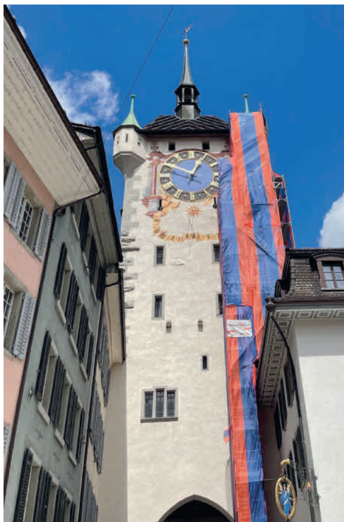
Stadtturm Baden mit Baugerüst für die fachgerechte Sanierung des Schadens
